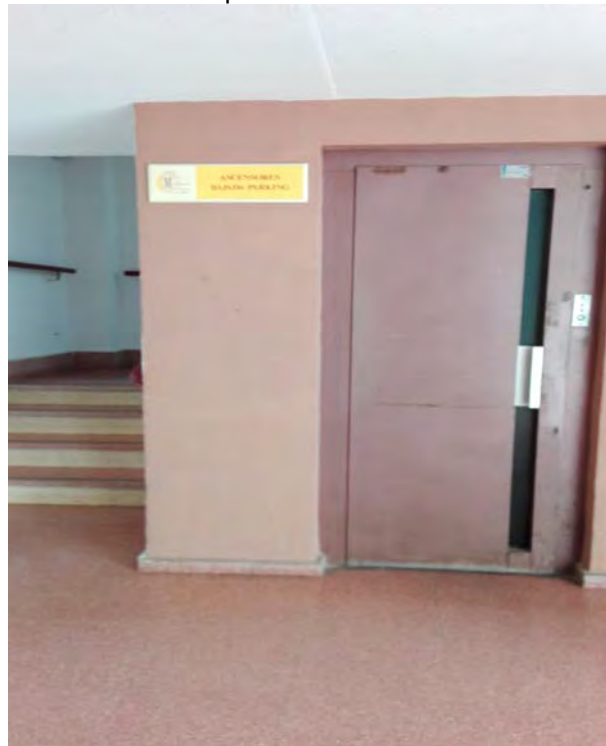
Vista interior de los núcleos de comunicación en el aparcamiento (Ausencia de vestíbulos de independencia)
