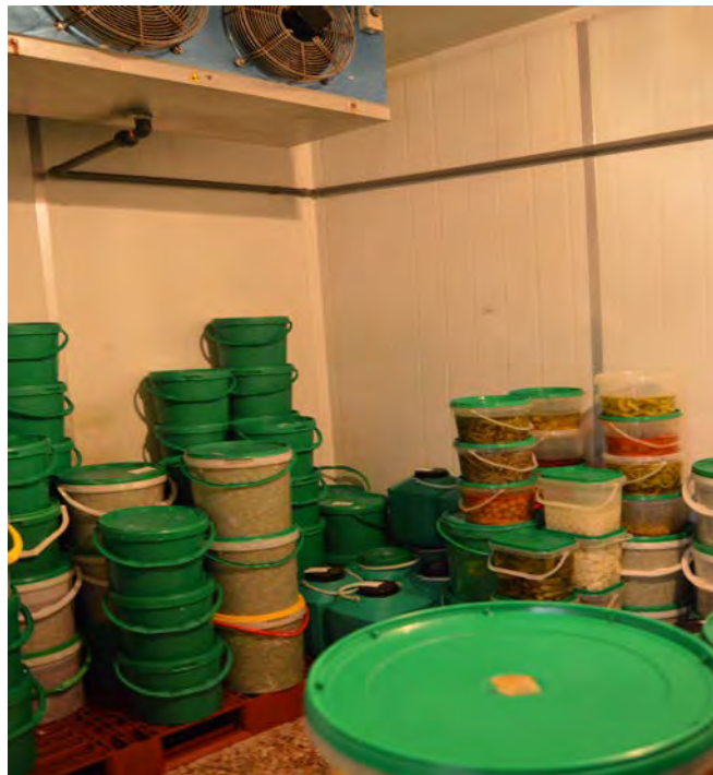
Interior de una de las cámaras refrigeradas
