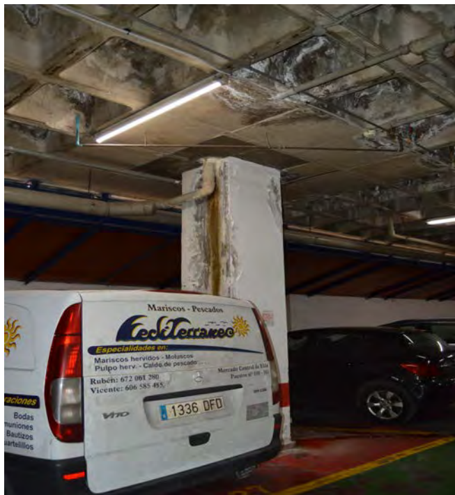
Vista de las humedades en estructura vertical y horizontal bajo el pasillo de servicio del área de pescados
