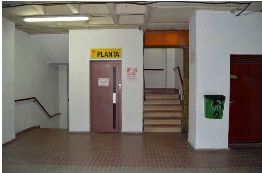
Núcleo de comunicaciones de acceso al mercado desde sótano (ausencia de vestíbulos de independencia)
