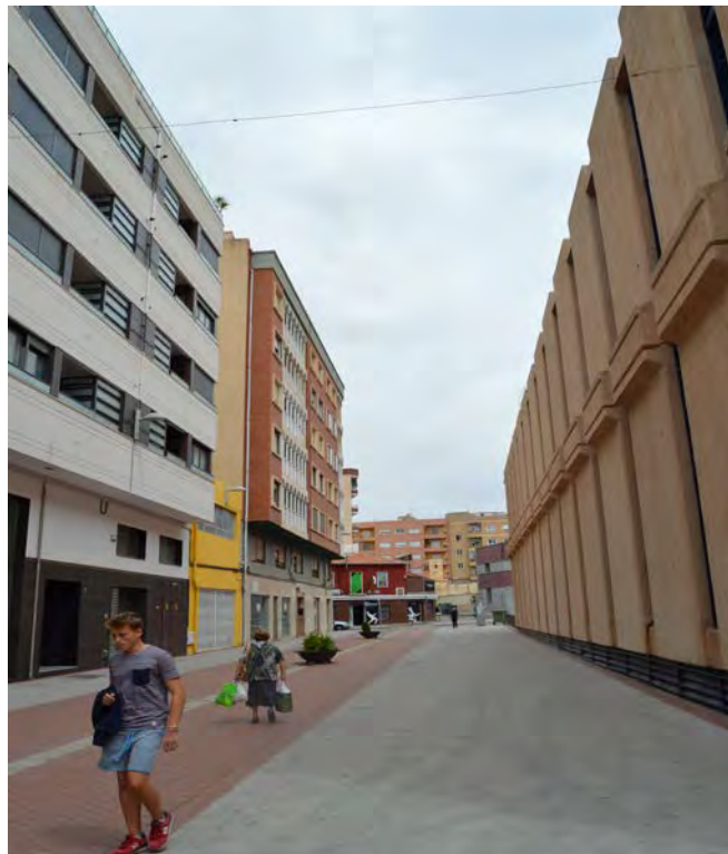
Vista fachada Fase 1 hacia Calle Reyes Católicos (Proximidad de las rejillas de ventilación al suelo produciéndose humedades)
