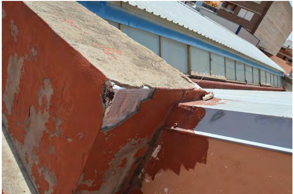
Vista del impermeabilizante al descubierto en algunos puntos singulares de los petos de la cubierta
