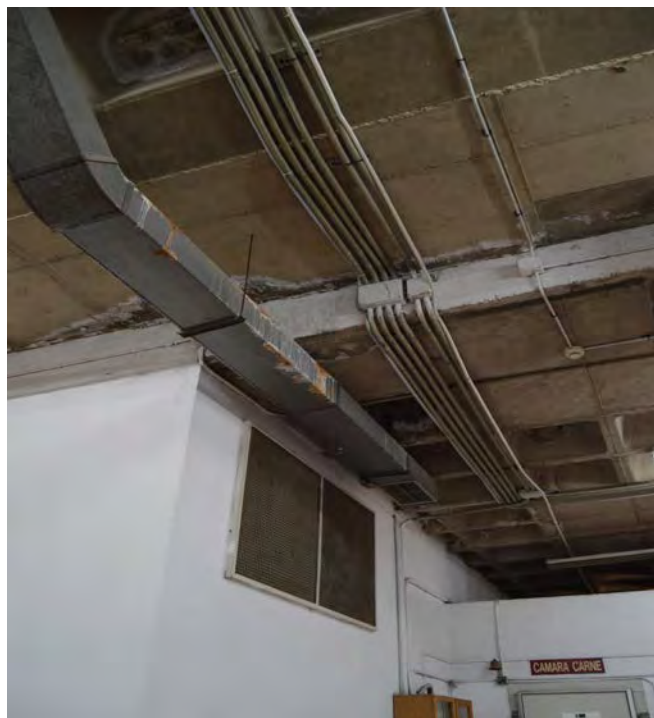
Vista del forjado superior reticular, destacan las humedades
