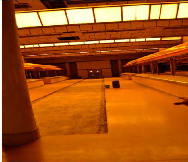
Vista de la antigua sala de mercado en planta primera, ahora cerrada (Presencia de filtraciones a través del lucernario)
