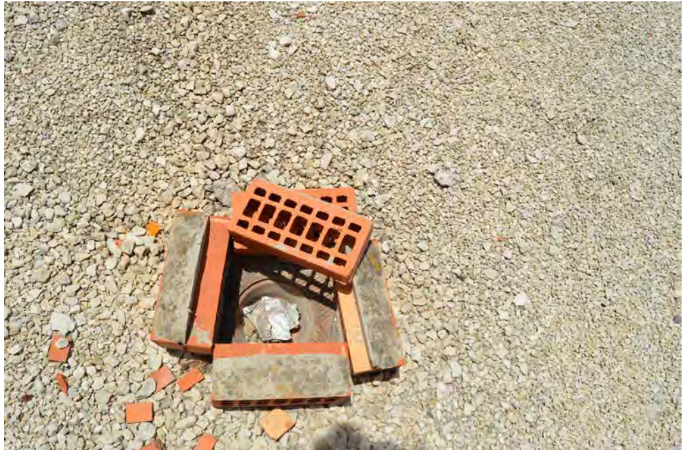
Vista de uno de los sumideros desprotegido de cubierta, que se encuentra colapsado
