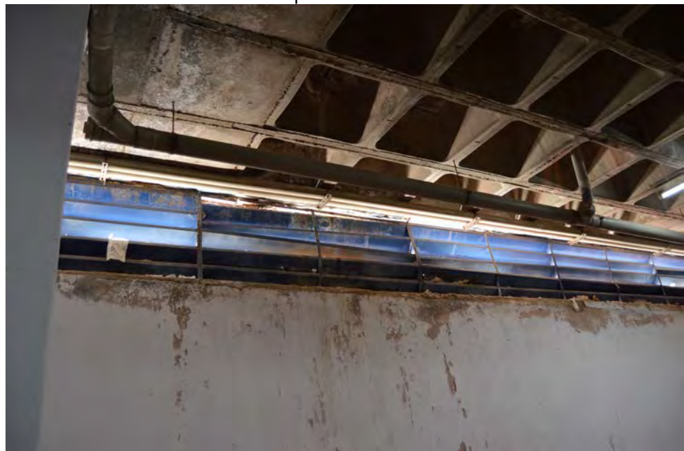
Vista de las humedades bajo las rejillas que se encuentran en contacto con la calle
